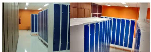
Figura 8. Escaninhos – falta de isolamento com o restante da biblioteca. Fonte: As autoras (2014).
